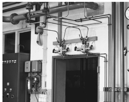
System automatycznej kontroli zaolejenia i zmętnienia kondensatu w dwóch oddzielnych instalacjach powrotu kondensatu.
